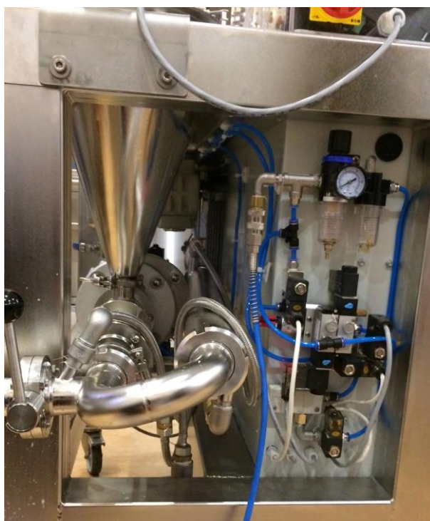
Rys. 4-59 Zamontowane komponenty pneumatyki
